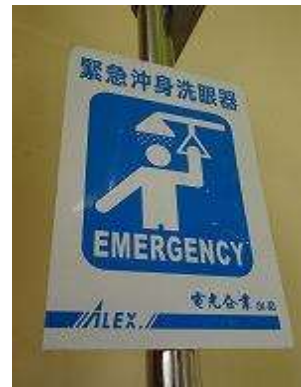
緊急時に使用するシャワーが設置されていました。
