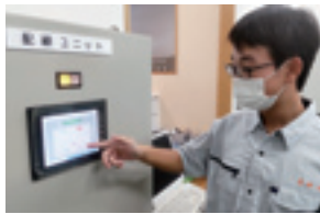
モニターによる電源操作
